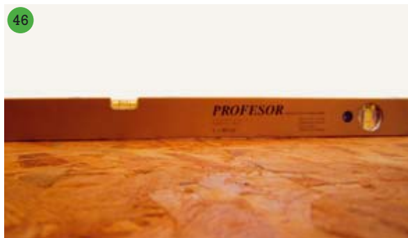
Ukázka průhybu podlahy
